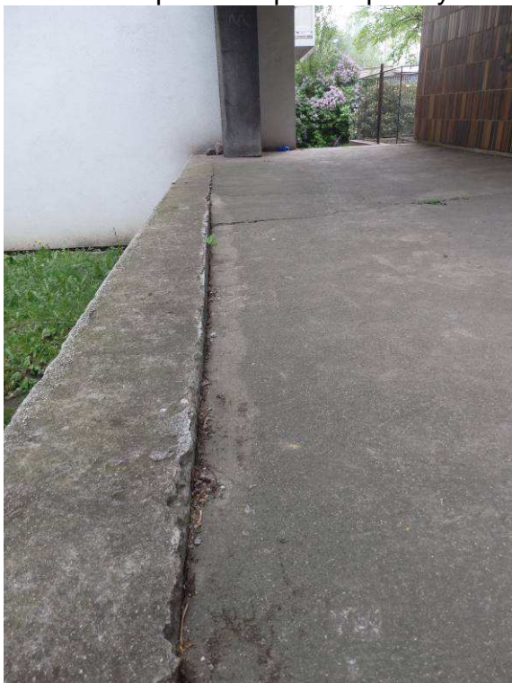
Foto č.14 – prosedlá plocha pod vyložení střechy u Modulu 1
