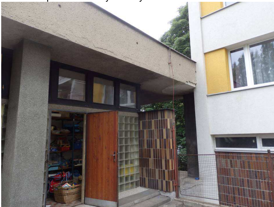
Foto č.9 – porušení římsy střechy
