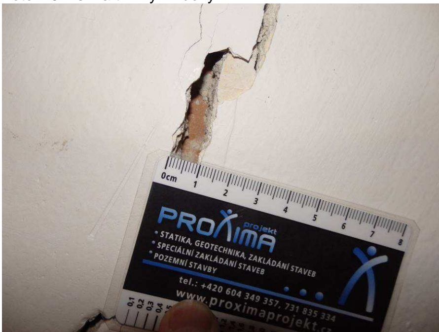
Foto č.6 – šířka trhliny v kuchyni
