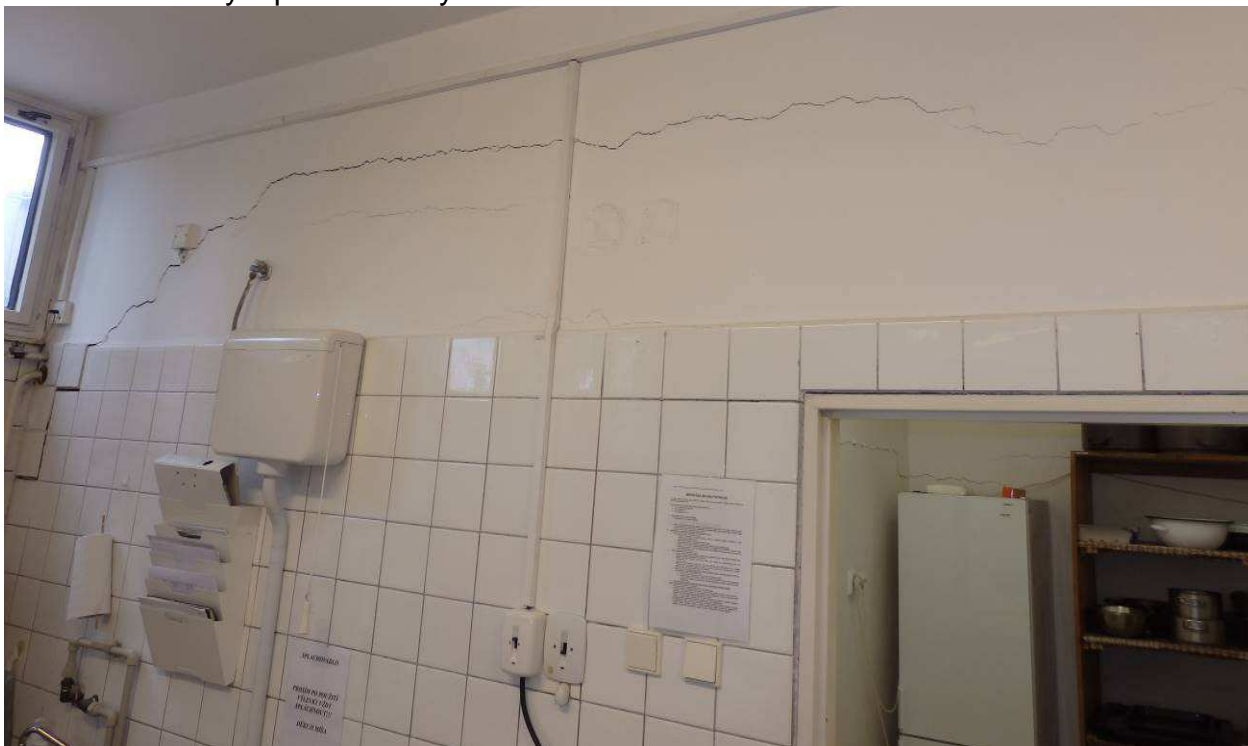
Foto č.4 – trhliny v příčce kuchyně
