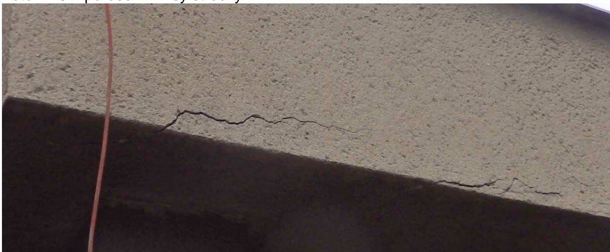
Foto č.10 – porušení římsy střechy
