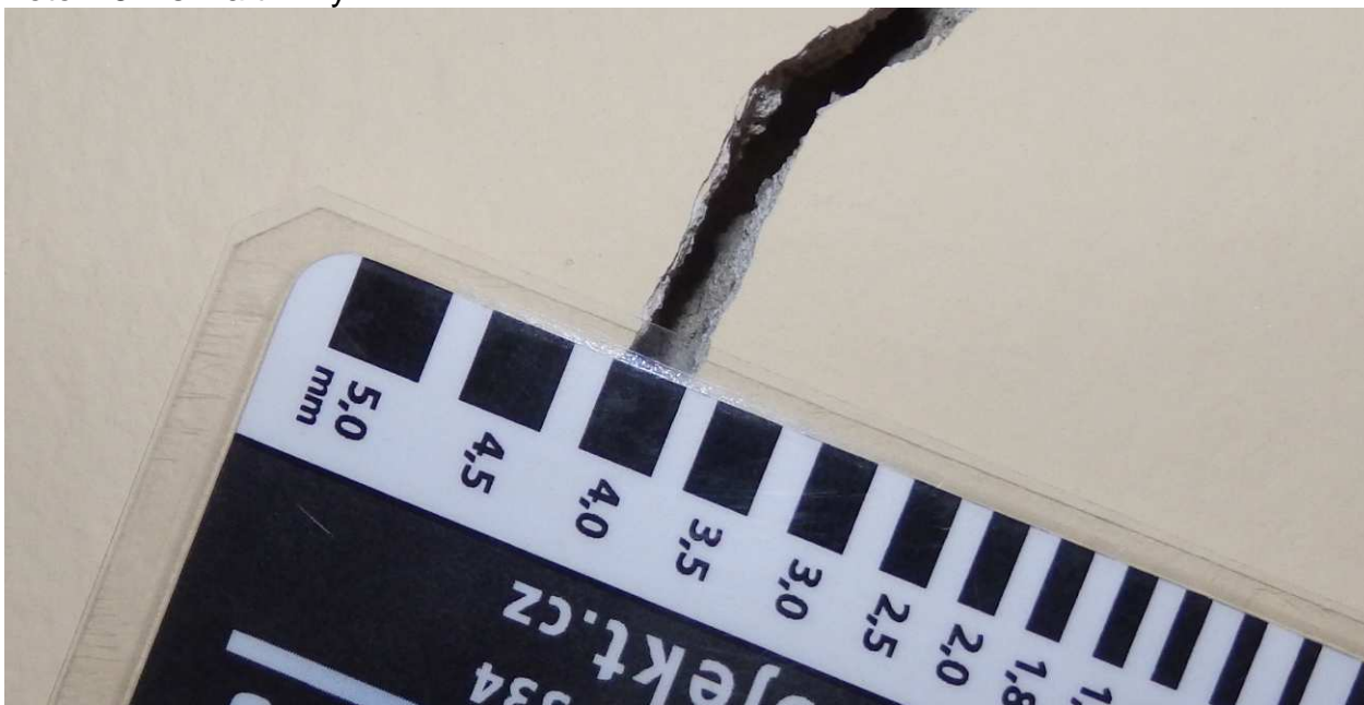
Foto č.8 – šířka trhliny
