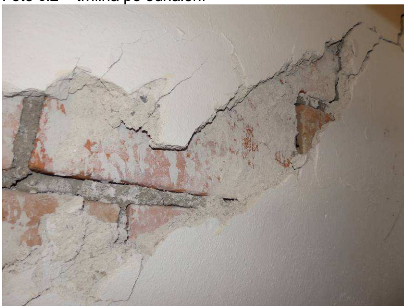
Foto č.2 – trhlina po odhalení
