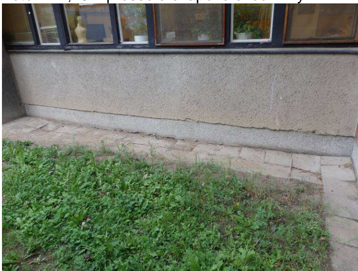
Foto č.12,13 – prosedlé okapové chodníčky
