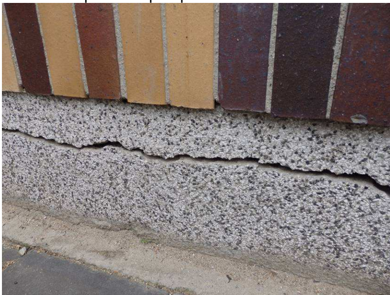
Foto č.11 – porušení parapetu
