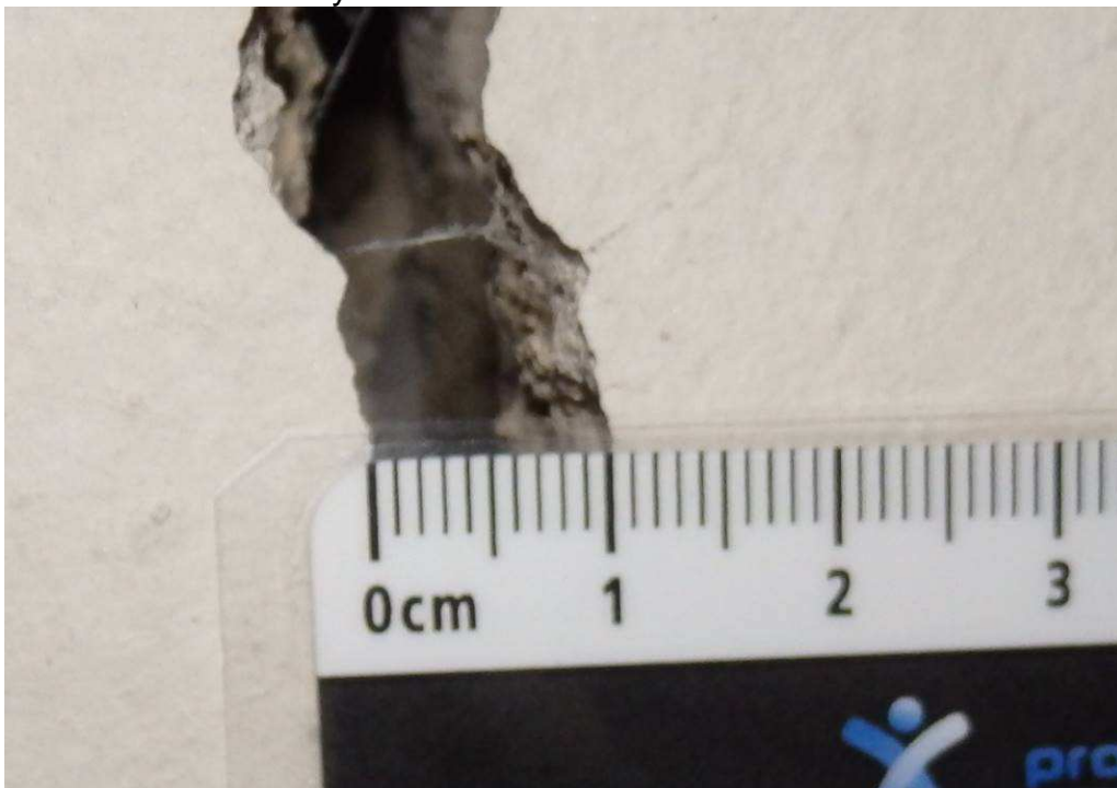
Foto č.3 – šířka trhliny
