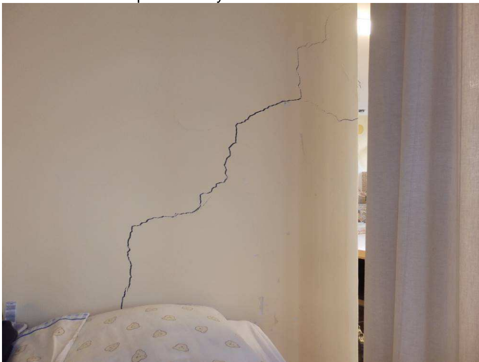
Foto č.7 – trhlina v příčce hery
