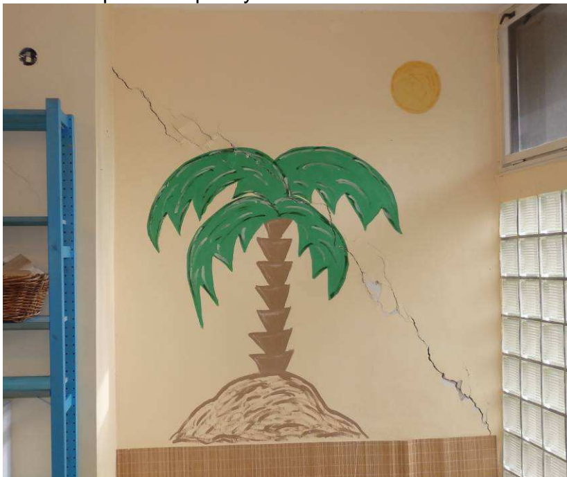
Foto č.1 - porušení příčky
