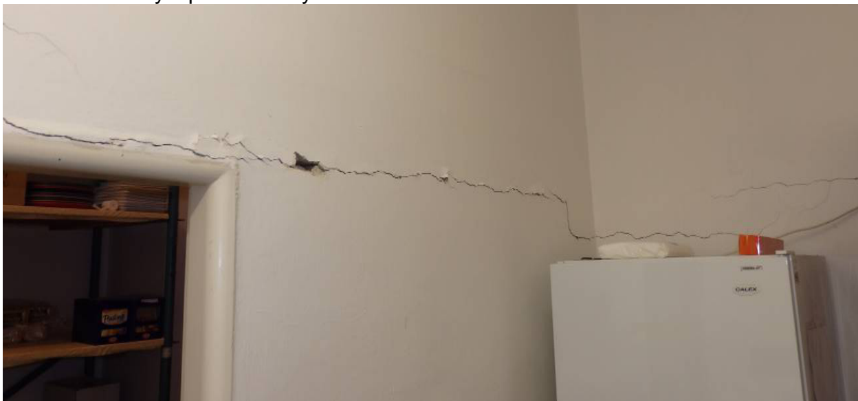
Foto č.5 – trhliny v přičce kuchyně
